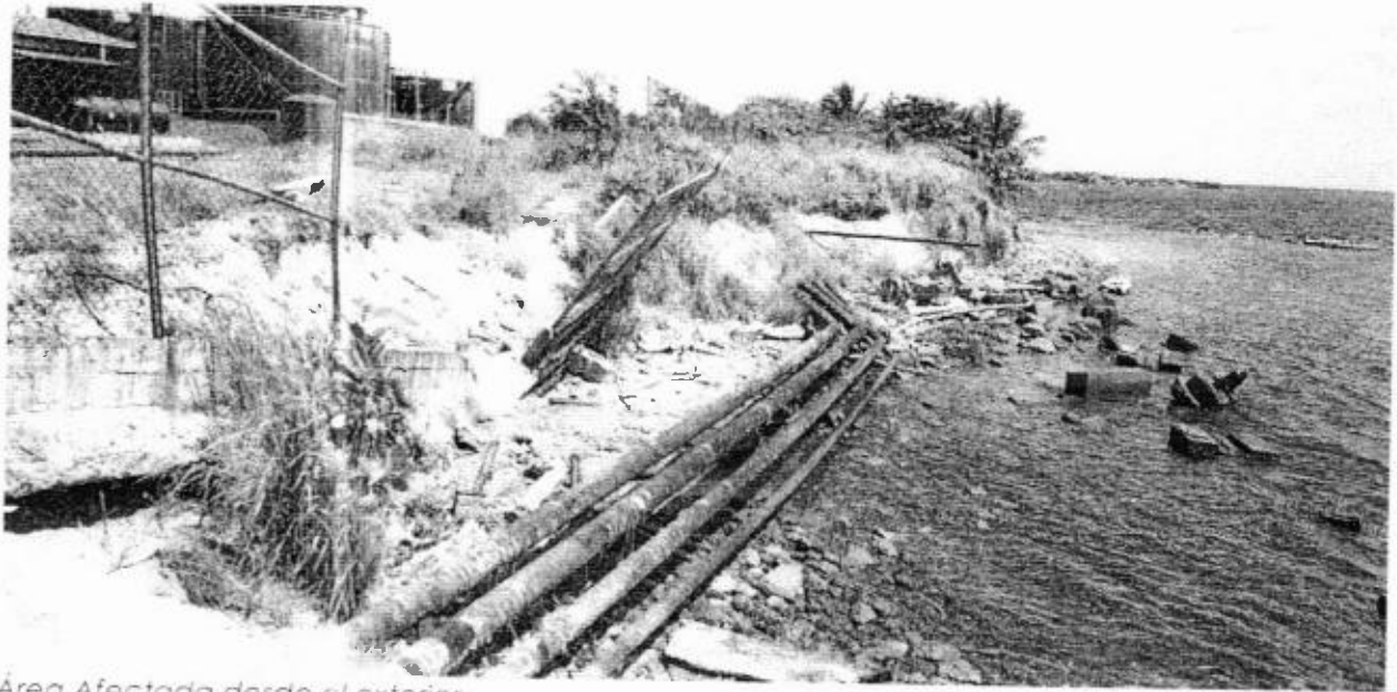
Área Afectada desde el exterior
