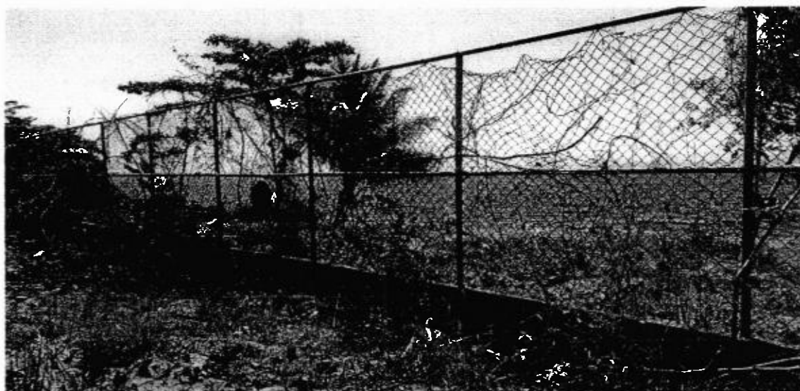
Áreas de malla ciclón a reparar
