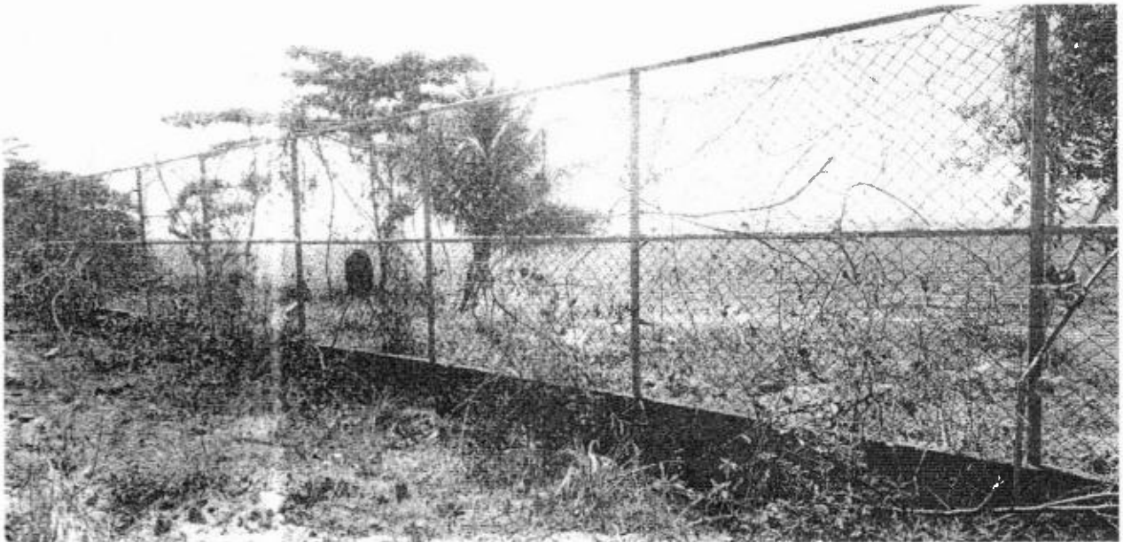
áreas de malla ciclón a reparar
