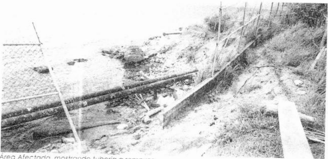
Area Afectada, mostrando tubería a remover
