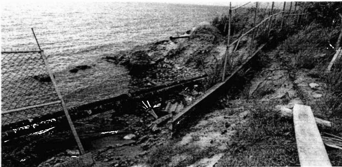
Área Afectada, mostrando tubería a remover
