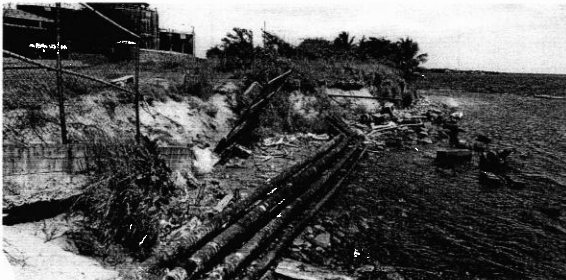
Área Afectada desde el exterior
